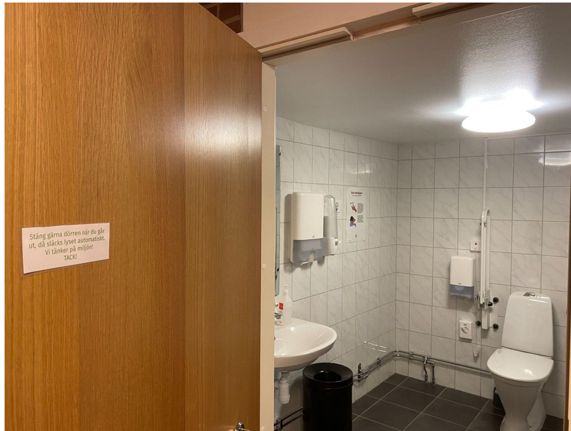
Installerat lampsläckare och snålspolande toa, 2017
